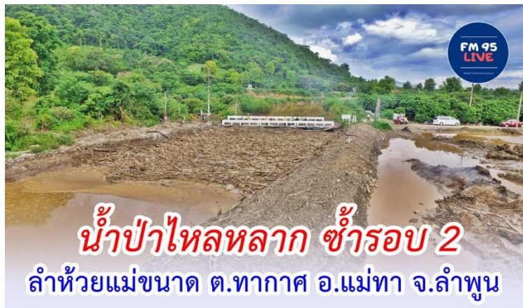
วันที่ 28 ก.ค. 63 น้ำป่าไหลหลากได้พัดพาตะกอนดิน หิน เศษซากวัชพืช กิ่งไม้ ต้นไม้ มาติดที่สะพานข้ามลำน้ำแม่ขนาต ในพื้นที่อำเภอแม่ทา จังหวัดลำพูน
